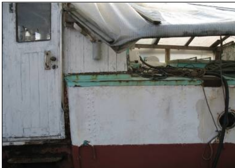
Forreste bagbord side af agterruf. Det valsede hjørne, og samling med ruftag ses.
